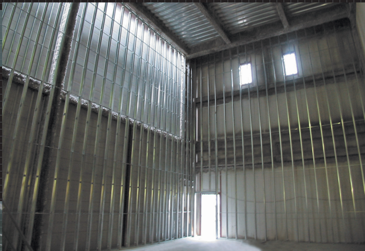
■軽鉄で10Mの間仕切壁。今まで不可能としていた事が実現しました。
