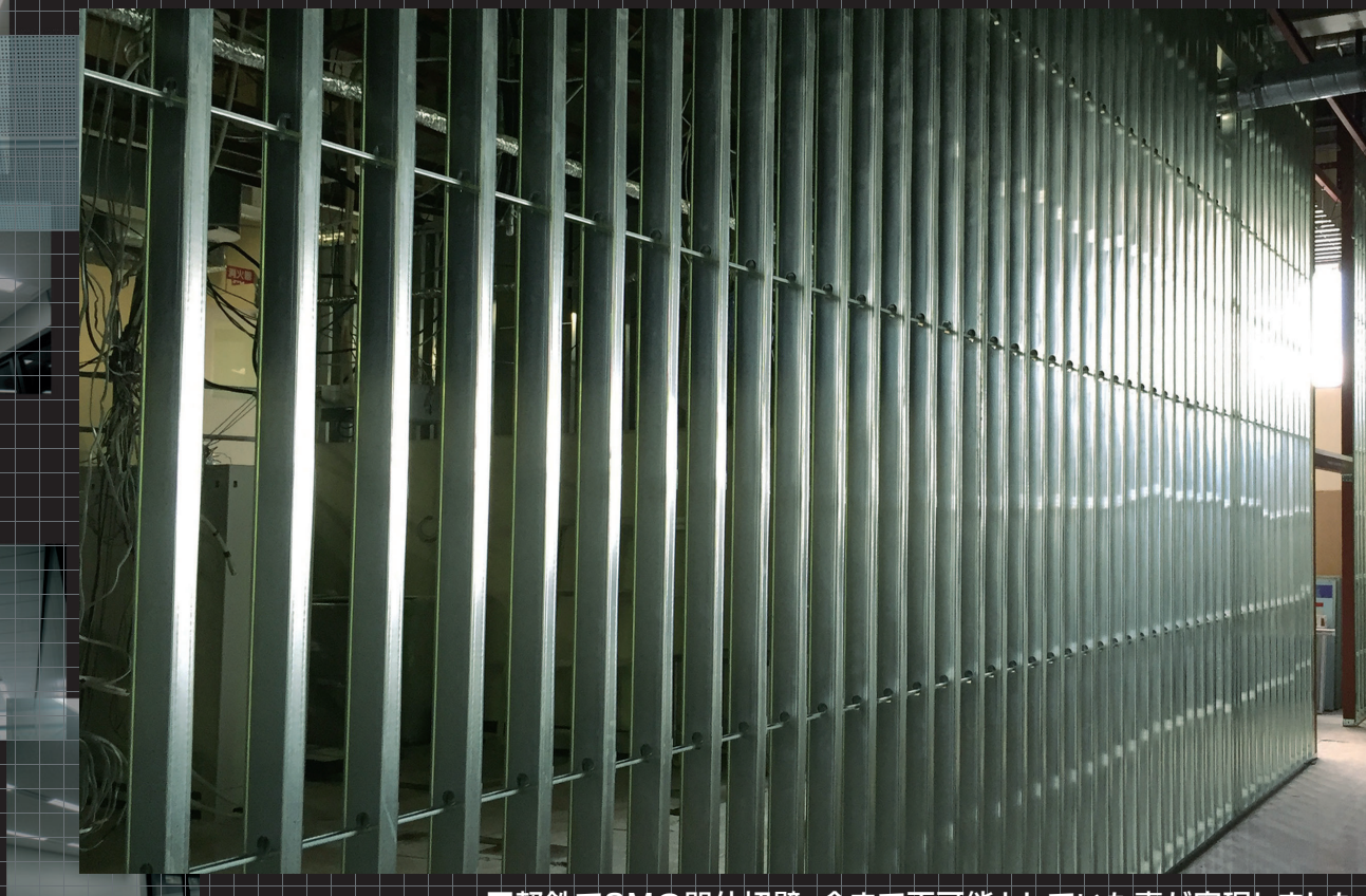
■軽鉄で9Mの間仕切壁。今まで不可能としていた事が実現しました。
